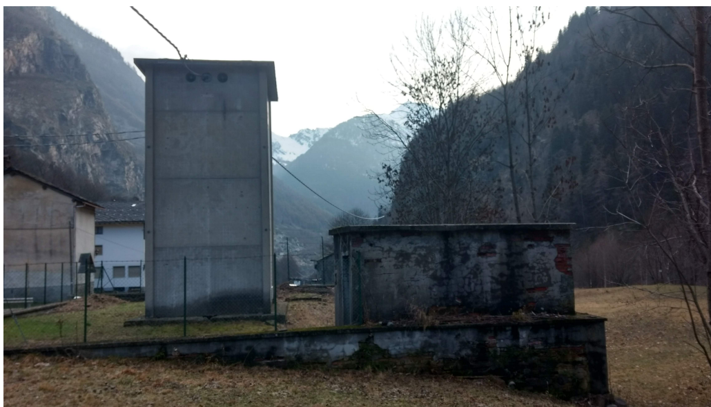
Figura 6.1: Manufatto diroccato un tempo adibito a locale trasformatore.
