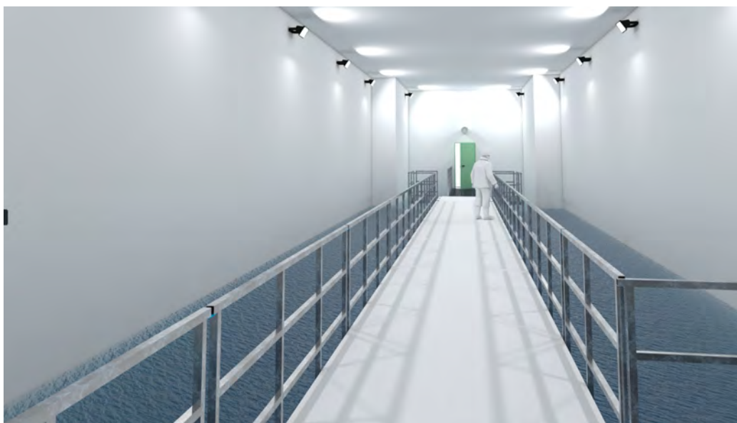
Figura 12.9: Vista interna della vasca di carico. In primo piano la passerella pedonale che divide la vasca di carico. Sullo sfondo la porta di accesso alla camera valvole.
