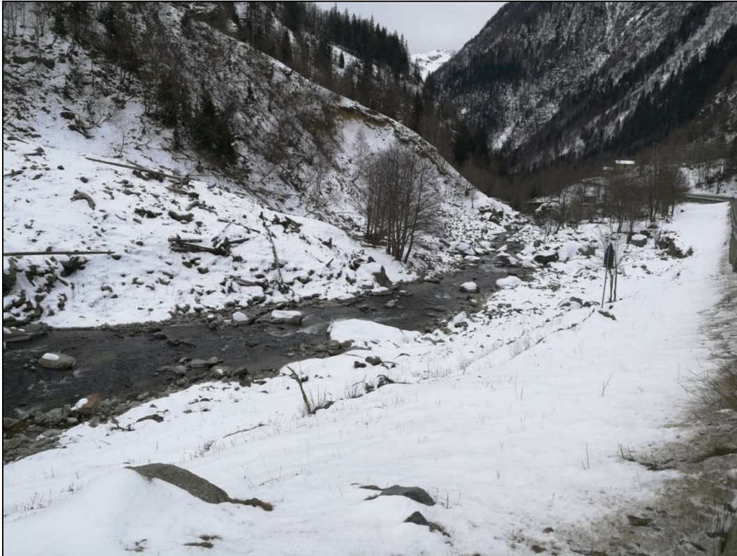
Figura 14: Alveo del torrente Lys a valle di Bédemié. Si notano le erosioni spondali in destra e sinistra nonché il dettaglio del conoide valanghivo della valanga di Taille Spitz.
