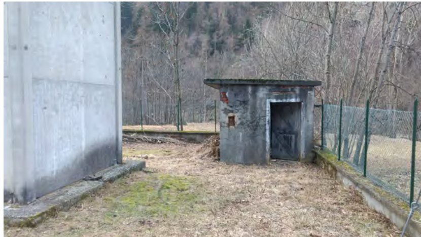
Figura 3.13: Sulla sinistra il torrino Deval in cui verrà consegnata l'energia prodotta. Sulla destra il fabbricato che verrà rifatto per ospitare le apparecchiature elettriche di sezionamento della linea.
