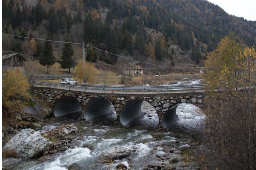
Figura 3.2: Vista da valle del guado attuale. Il guado verrà rimosso e sostituito con l'opera di presa in progetto sormontata dal nuovo attraversamento.
