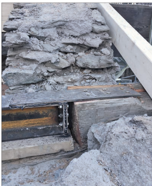
14. Aggancio tra la trave lignea dell'avantetto e la nuova terza metallica. (S. Martino)
