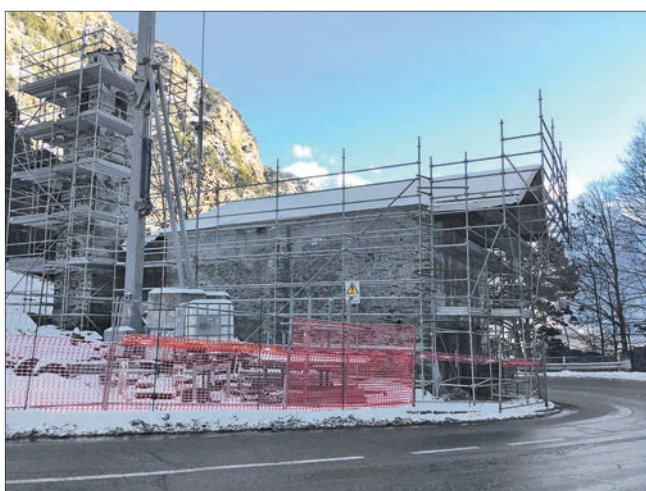
8a.-b. Lato est (in alto) e lato nord (in basso) durante i lavori. (S. Martino)
