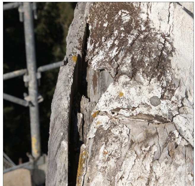
6a.-b. L'avanzato stato di degrado aveva comportato la consumazione delle finiture pittoriche superficiali e l'erosione del supporto ligneo, che presentava distacchi tra le parti e profonde spaccature. (Pm. Reboulaz)
