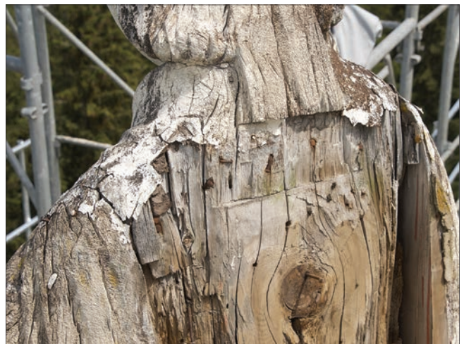
7. Sul retro della scultura, la rimozione del pannello di rifacimento ha messo in evidenza il grave deterioramento del supporto ligneo, sul quale erano presenti numerosi chiodi in ferro ossidati. (Pm. Reboulaz)
