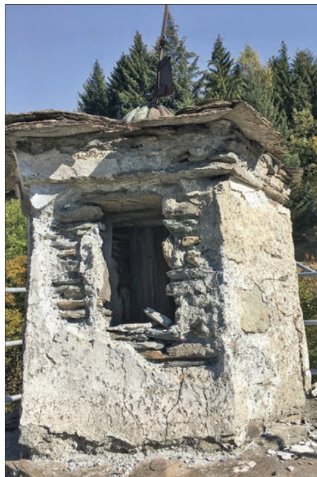
15. Stato di conservazione della cuspide del campanile. (S. Martino)
