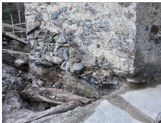
9. Degrado e marcescenza della trave lungo il lato del campanile. (S. Martino)
