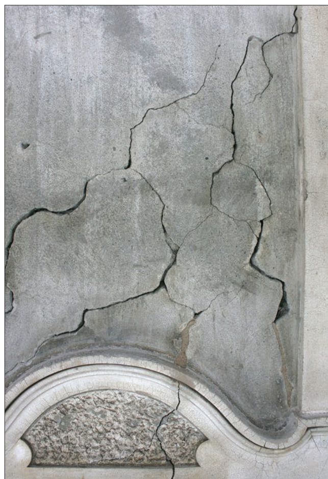
27. Consolidamento strutturale dell'intonaco fratturato e distaccato. (N. Cuaz)
