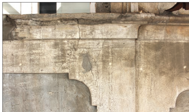
14. Superficie investita da depositi, colature cementizie, macchie provocate dalla migrazione degli ossidi di ferro dei chiodi di armatura interna, fessurazioni e distacchi.
