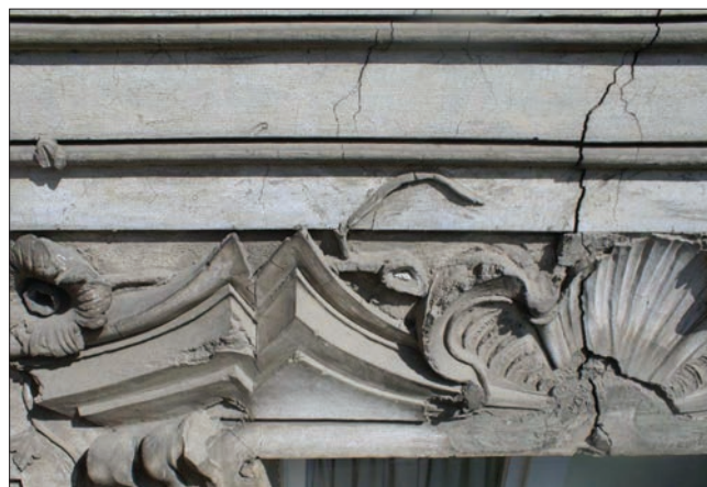
12. Particolare dello stato di conservazione. (N. Cuaz)
