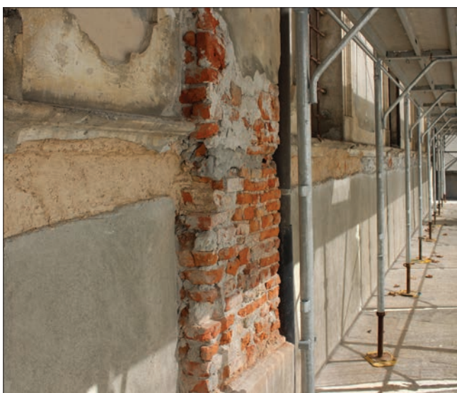
23. Ricostruzione delle lesene e realizzazione di un cordolo di malta di calce per isolare il cemento dalle eventuali future migrazioni saline. (N. Cuaz)
