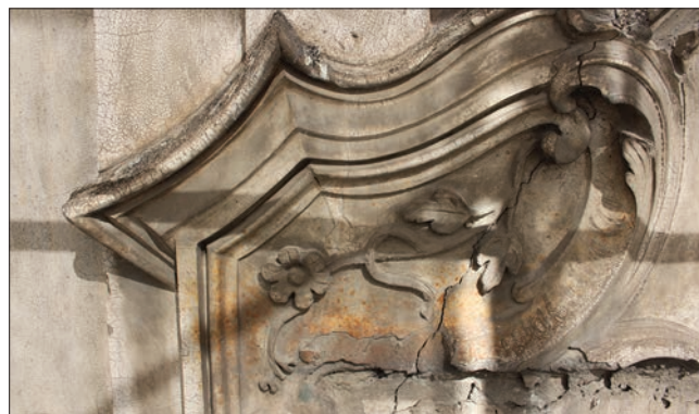
15. Particolare del degrado degli stucchi.
