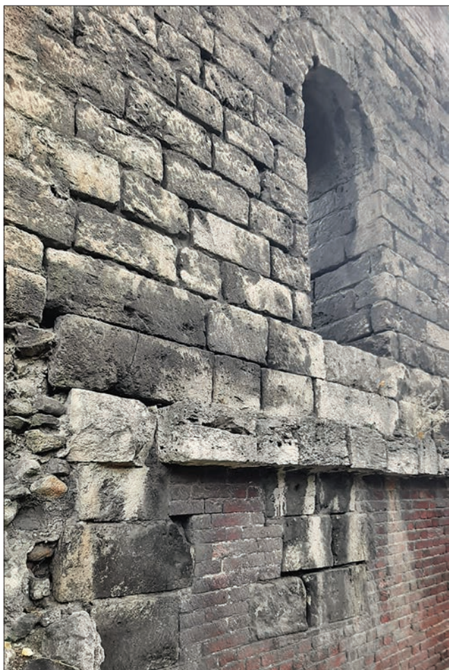
5. Particolare della muratura con segni di degrado: percolamenti, croste nere, disgregazione superficiale, presenza di crescita di vegetazione. (K. Papandrea)
