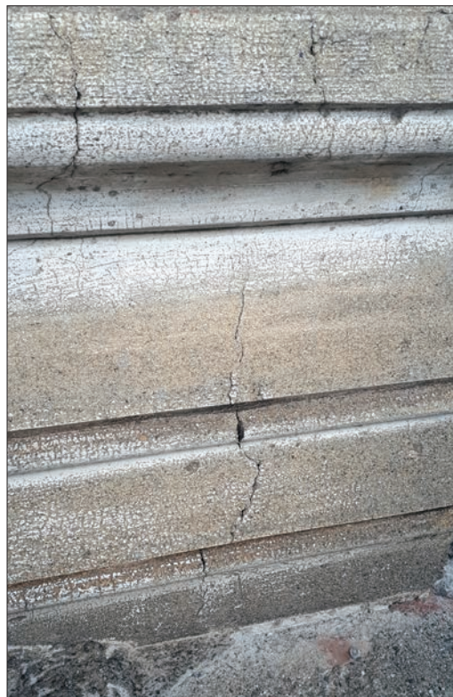
13. Particolare dello stato di consumazione superficiale e delle cavillature.
