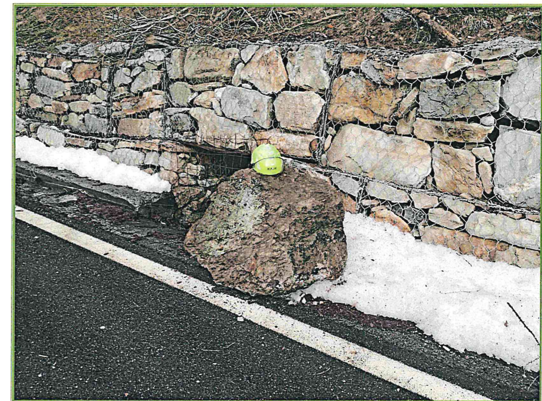
FOTO 3: particolare di un blocco arrestatosi sulla cunetta lato monte della sede stradale
