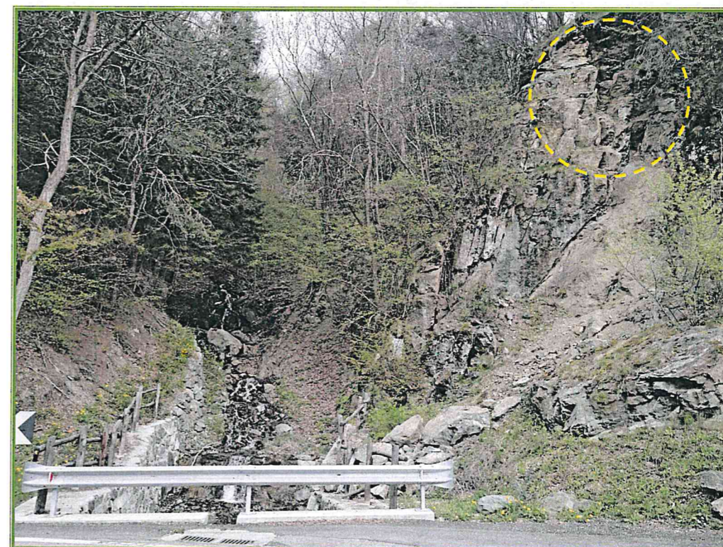
FOTO 2: vista frontale della zona del crollo sulla sponda sinistra idrografica del torrente Cillian
