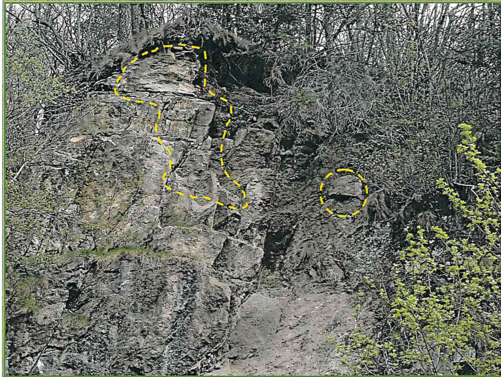
FOTO 3: particolare della nicchia di distacco con evidenza di residue porzioni ancora instabili da disaggiare, di vegetazione da rimuovere e di necessità di scoronamento della parte alta
