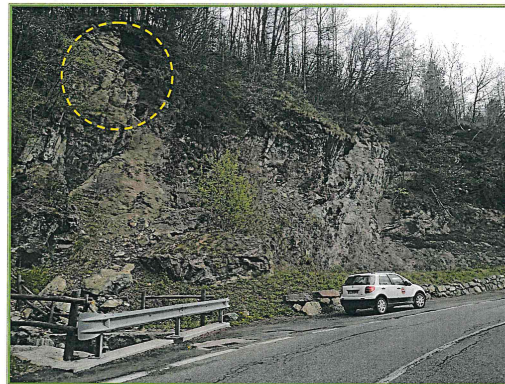
FOTO 1: vista della parete rocciosa da valle dell'attraversamento della SR n. 33 (km 7+730) con la nicchia di distacco sulla parte in alto a sinistra dell'immagine
