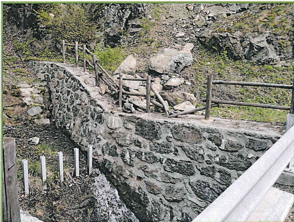
FOTO 4: vista del deposito del materiale lapideo crollato che si è arrestato in buona parte contro il parapetto esistente danneggiandolo
