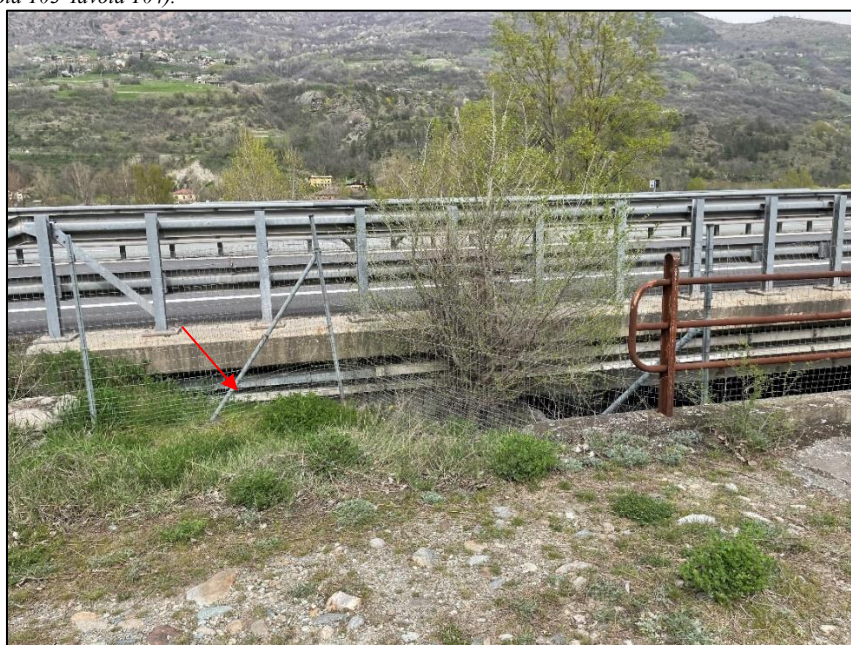
Figura 4: Dettaglio fotografico che evidenzia la vicinanza del ponte in oggetto e il ponte autostradale. Evidenti le tubazioni che ospitano le linee elettriche e di rete, staffate al ponte autostradale (freccia rossa).
