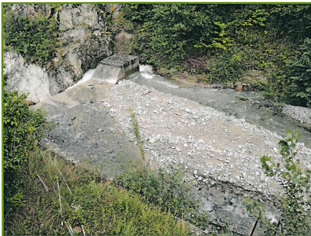
FOTO 3 : vista da monte del bacino della briglia con erosione in sponda DX
