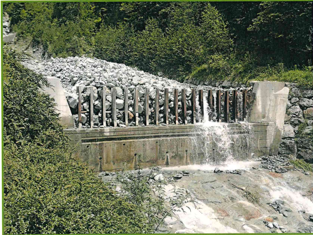
FOTO 3 : vista laterale della briglia 1 e del suo filtro completamente ostruito
