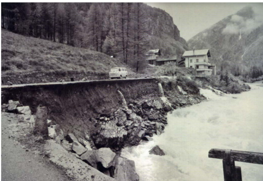
Erosioni spondali presso il ponte di Lillaz, il ponte di Champlong ed il torrente Urtier
