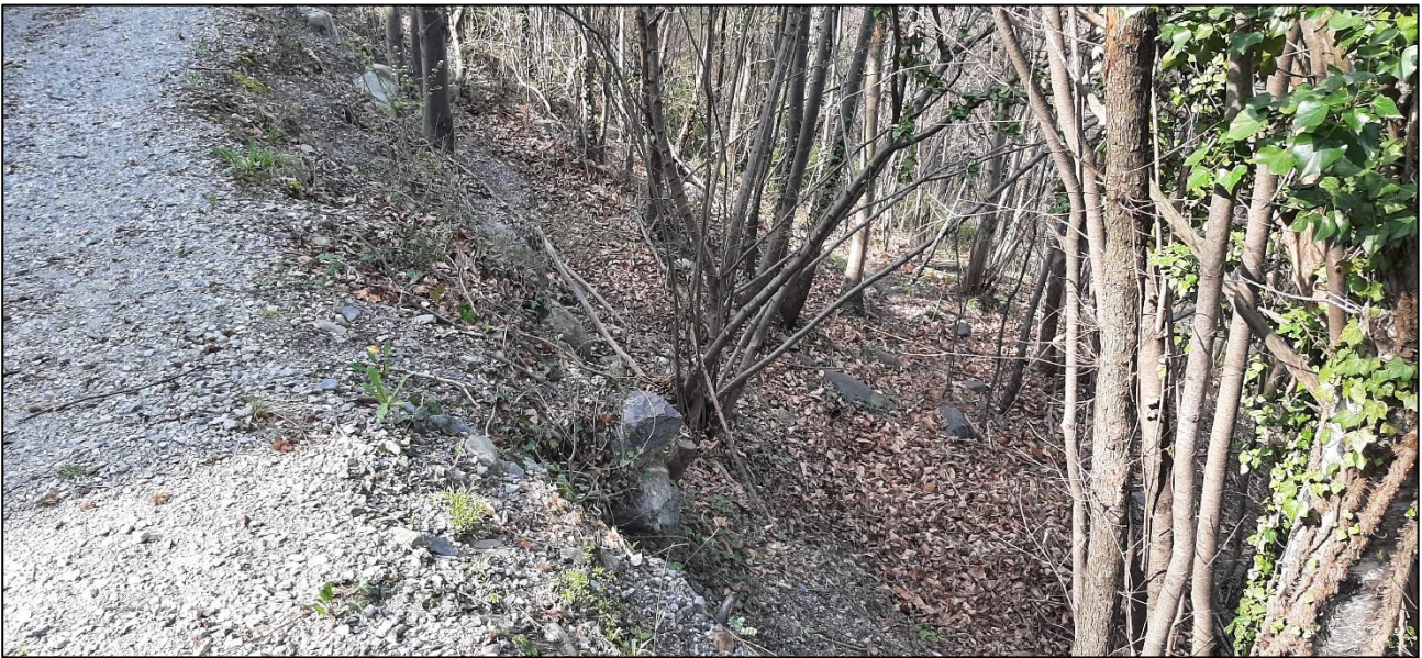
FIGURA 6-5 VISTA DEL VERSANTE A VALLE DELLA VIABILITÀ RURALE IN CORRISPONDENZA DEL 1° TORNANTE SOTTO L'AREA CIMITERIALE
