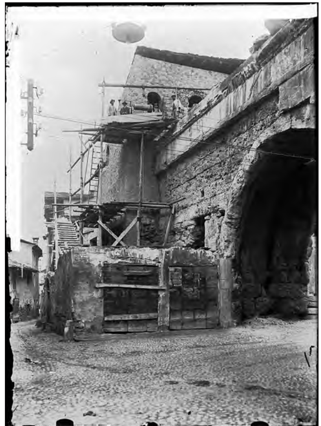
13. Lavori di demolizione degli edifici addossati al fornice meridionale, 1926. (Archivio beni archeologici SBAC)
