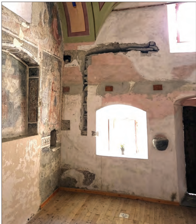
12. Parete di controfacciata, resti di un ampio portale. (N. Cuaz)
