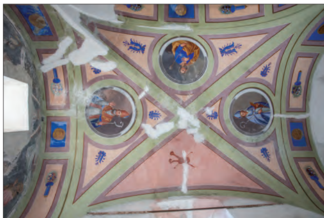
10. Volta ottocentesca della porzione dell'aula a ridosso del dipinto quattrocentesco prima del restauro. (P. Rosetta)
