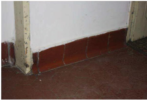
Piano rialzato – alloggio Est – particolare del battiscopa stonato in ceramica.
