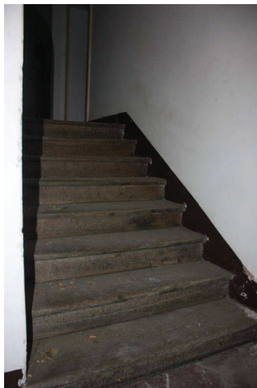
Particolare della scala interna al piano rialzato con particolare dell'alzata e della pedata in legno.
