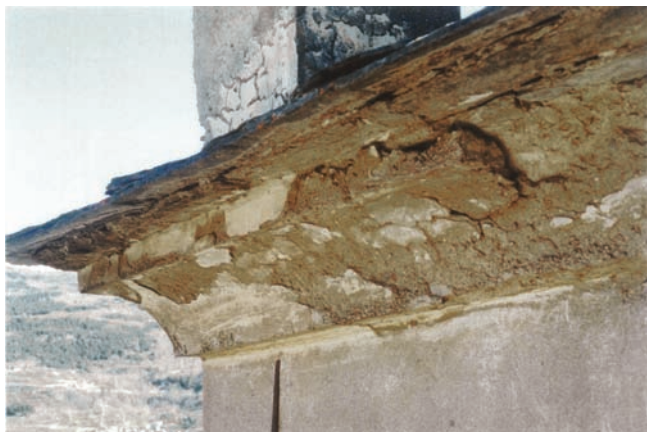
2. Particolare del cornicione alla base della cuspide: evidente il deterioramento dell'intonaco. (F. Accordi)
