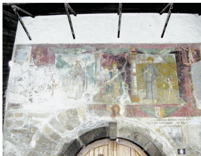
1. Dipinto murale di santa Caterina prima dell'intervento di restauro, la ripresa da terra mostra una situazione identificabile con presenza di sali sulla superficie che solo la visione da vicino dopo l'allestimento del ponteggio ha dimostrato essere errata. (L. Appolonia)
