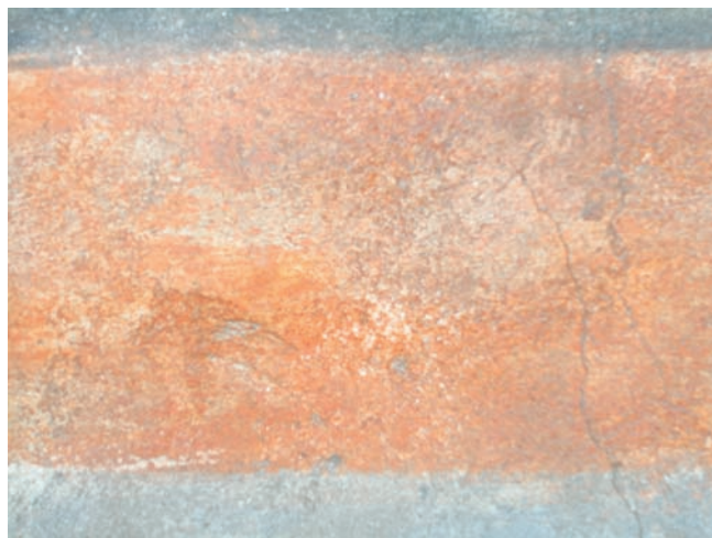
3. Exemple de portion de mur avec fissures et érosion de la couleur. (L. Degani)
