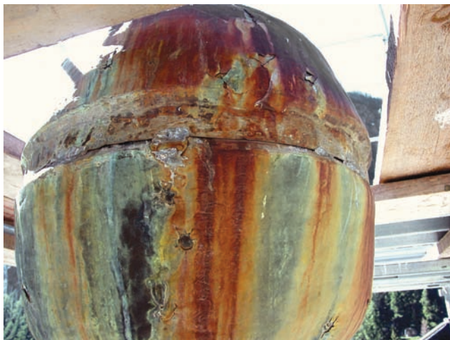
2. Elemento sferico in rame, posto alla base della croce sommitale, con le forature causate da colpi di fucile. (I. Perrin)
