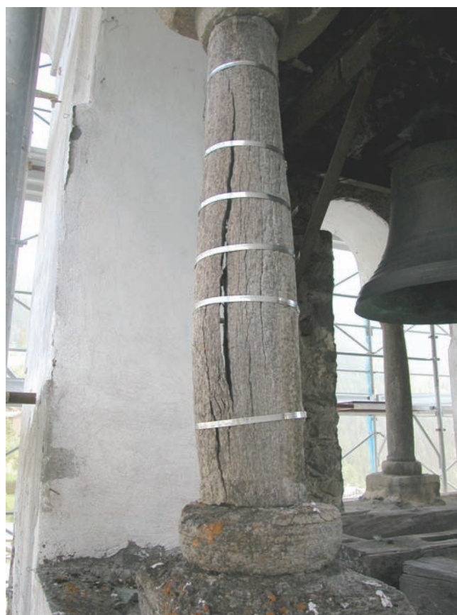
3. Colonna in avanzato stato di degrado messa in sicurezza con fasce di alluminio. (M. Monegato)
