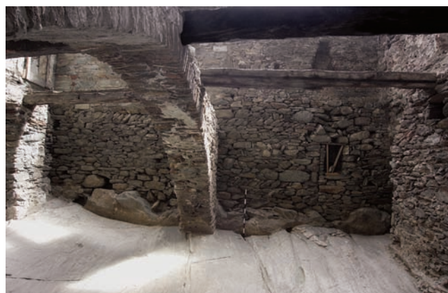
8. Alla base della struttura sullo sfondo le fondamenta del precedente edificio. (S.E. Zanelli)
