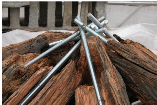
5. Particolare di una fase del consolidamento delle travi del tetto della torre. (Studio Architettura)
