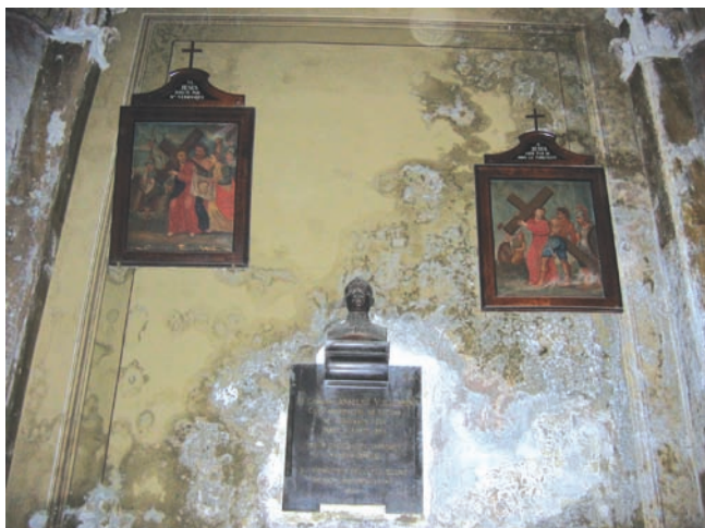
3. Interno della chiesa parrocchiale. Il degrado della muratura perimetrale della navata sinistra. (M. Lévêque)
