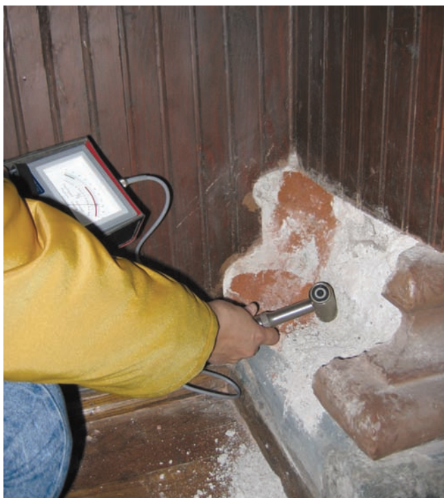
5. Interno della chiesa parrocchiale. Le misurazioni dei livelli di umidità alla base della parasta dello spigolo sud-est. (M. Lévêque)
