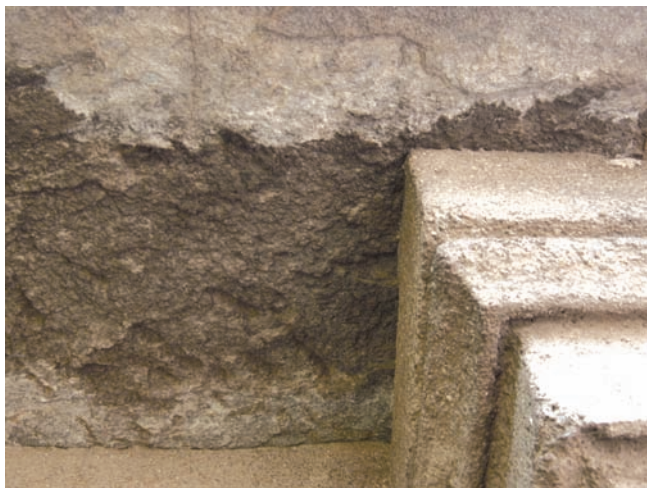
27. Deposito biologico dovuto al guano. (A. Idone)
