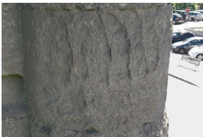
7. Degradazione (erosione) differenziale. (A. Idone)
