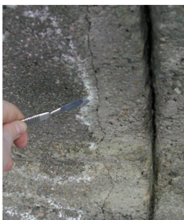
10. Fessurazione. (A. Idone)
