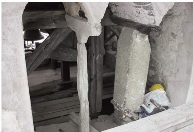
4. Particolare di due colonnine delle trifore prima dell'intervento. (S. Togni)
