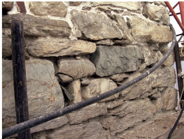
2. Particolare dello stato di conservazione delle superfici esterne: mancanza di malta di allettamento delle pietre. (M. Monegato)
