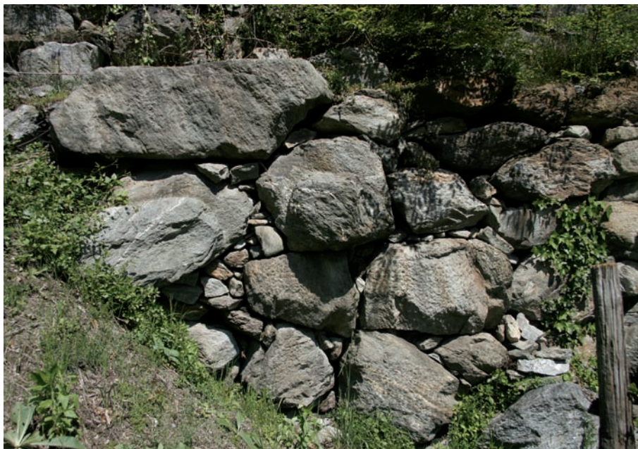
2. Sostruzione della strada antica: uno dei tratti in opera pseudopoligonale. (L. Caserta)
