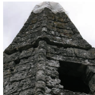
15. Particolare campanile prima del restauro. (N. Dufour)
