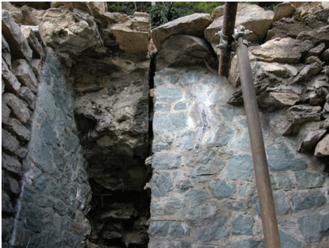
7. Rilievo (G. Abrardi) e fotografia (R. Perinetti) del setto in muratura perpendicolare all'asse stradale.
