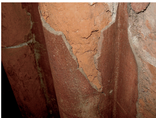
2. Esempio di decoesione del cotto sotto il rifacimento cementizio oramai fortemente alterato. (S. Pulga)
