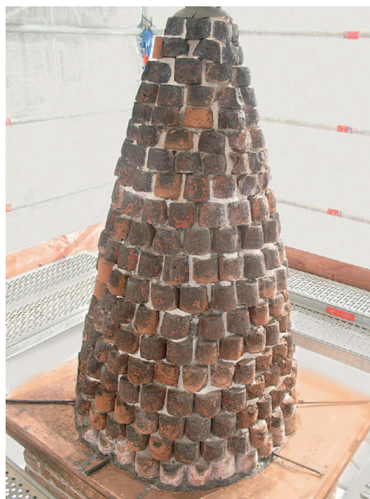
3. Esempio di integrazione, ancora non completata dal punto di vista cromatico, tra i giunti dei conci del pinnacolo centrale sopra il campanile a vela. (S. Pulga)
