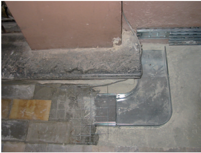
2. Particolare nuovo inserimento distribuzione orizzontale in canalina. (S. Togni)
