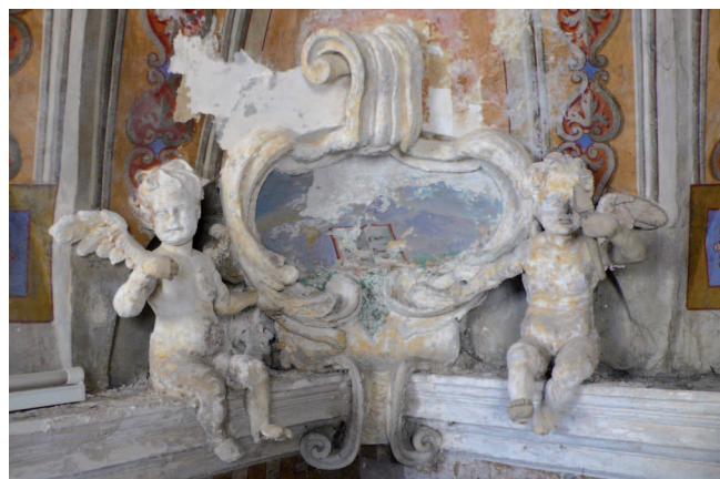
4. Angolo sud-est degradato. (D. Costantini)
