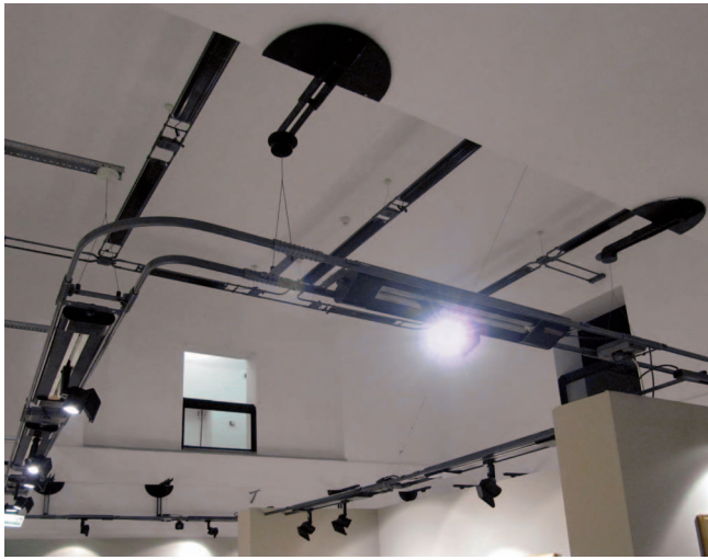
2. Stato attuale: particolare del sistema di illuminazione. (P. Fioravanti)
