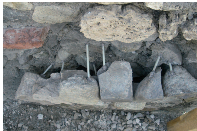
9a. Ancoraggio di una porzione di paramento in ciottoli e cemento mediante barre di connessione in vetroresina. (D. Capaldini - COO.BE.C.)
