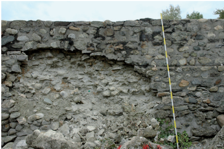
3. Esempio di crollo di un paramento murario ricostruito in cemento e ciottoli, nel corso di interventi del secolo scorso, su una struttura di un vano dei postscaenia . (D. Capaldini - COO.BE.C.)
