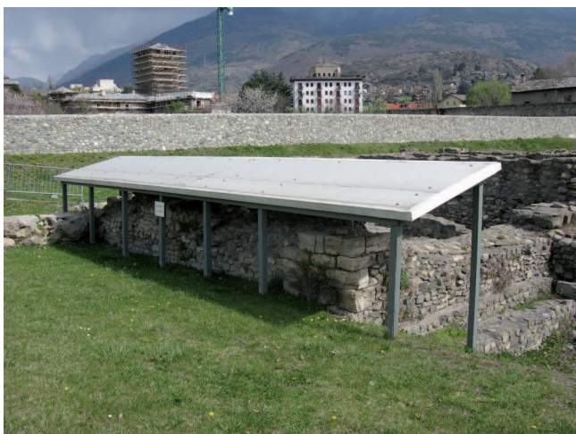
7. Tettoia coibentante realizzata per la protezione di una struttura muraria presente sul lato ovest dell'area. La struttura portante in legno è stata mimetizzata al fine di attenuare l'impatto visivo che essa determinava. (C. Pedeli)
