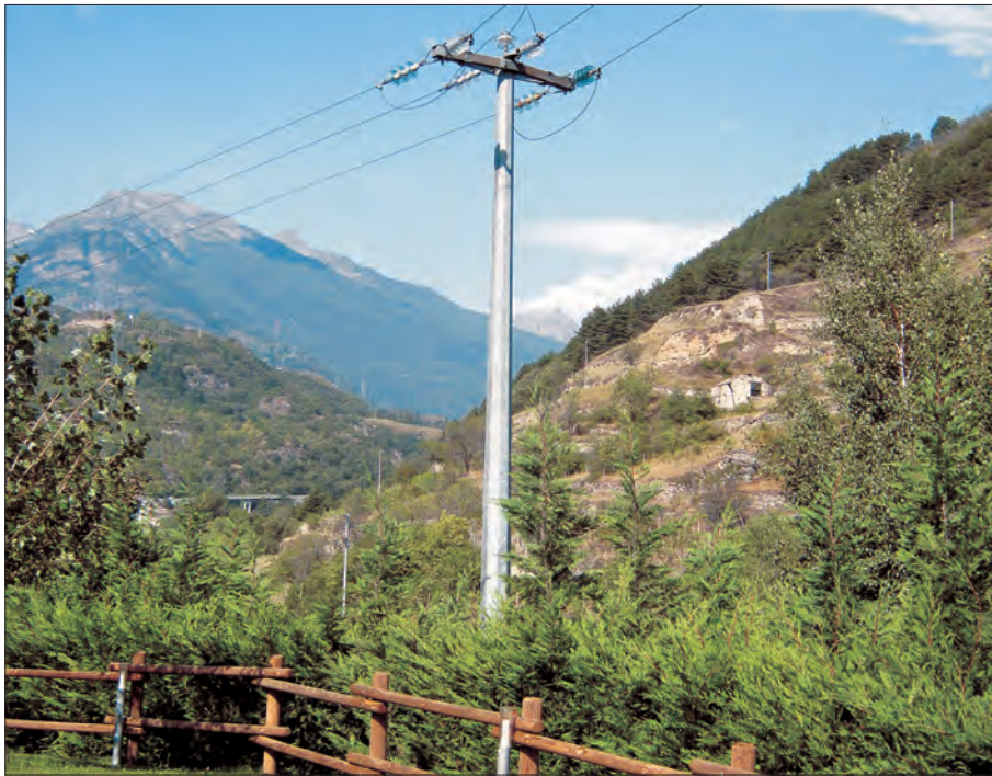
Elettrodotto a 15 kV in località Trepoint, in comune di Villeneuve.
