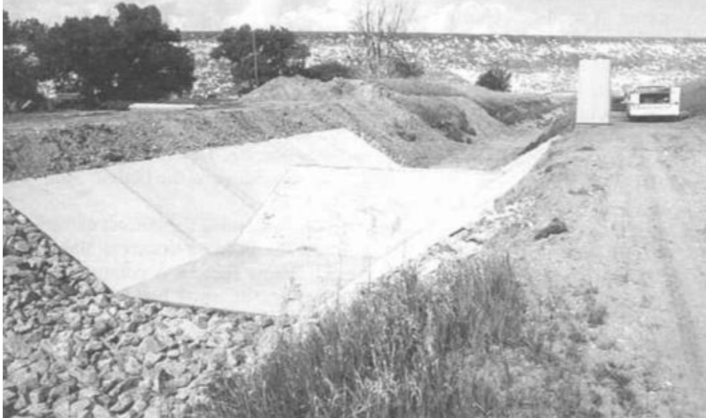
Figura 52 - Realizzazione di un misuratore a risalto in alveo naturale.
