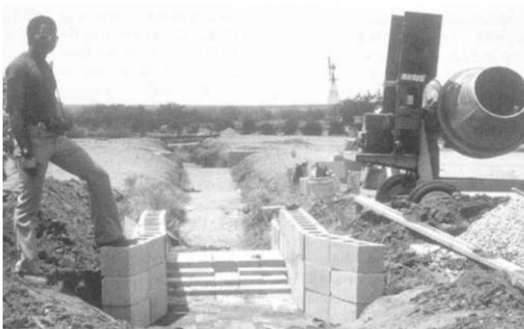
Figura 54 - Realizzazione di un misuratore a risalto con l'impiego di blocchetti in cls.
