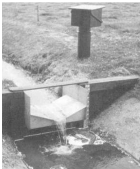
Figura 55 – Realizzazione di misuratore a risalto con lamiera metalliche e tavole di legno.
