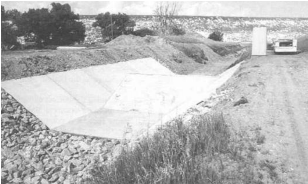
Figura 53 - Messa in funzione del misuratore a risalto in alveo naturale.
