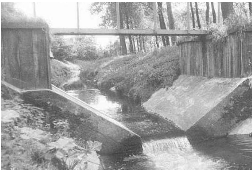
Figura 51 - Misuratore idraulico realizzato in corrispondenza di un attraversamento esistente.
