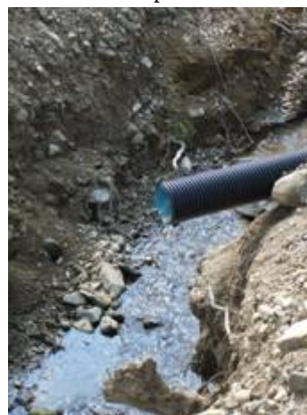
Acqua uscente dall'impianto presso "Cantina vinicola Canalicchio di Sotto"
