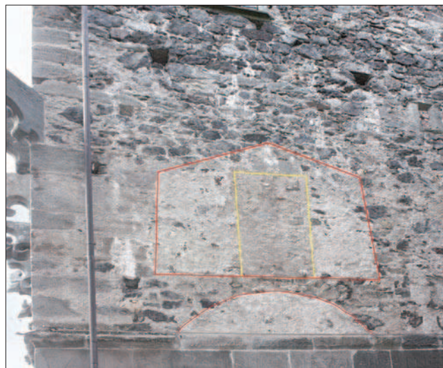
4. Façade Est de la Tour de Charles de Challant, où est signalée la position probable de la galerie reliant la chapelle et la tour. (G. Sartorio)
