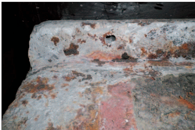
2. Situazione di degrado delle lastre. (Cooperativa de la Ville)
