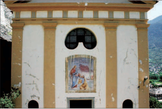
1. Lo stato di degrado della facciata prima dell'intervento. (S.E. Zanelli)
