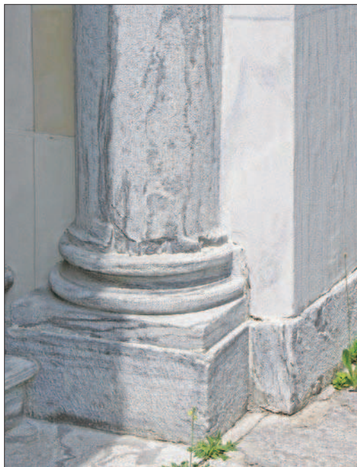
1. Aymavilles, castello. Prospetto sud, vestibolo, particolare della semicolonna in bardiglio e della lesena laterale intonacata a finto marmo. (F. Filippi)
