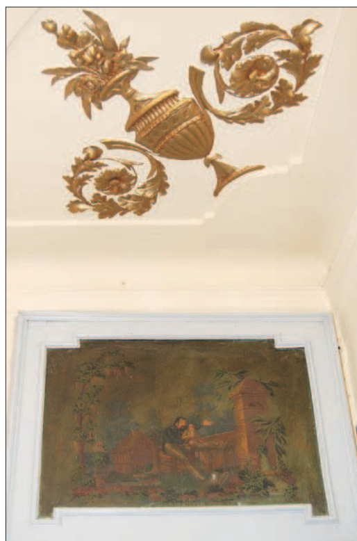
9. Particolare sovrapporta interno decorato e decoro a soffitto del primo piano. (A. Novel)
