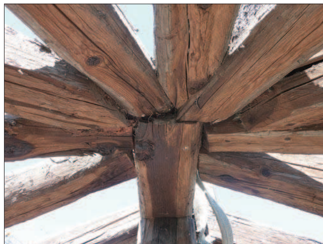
2. Particolare nodo di appoggio prima dell'intervento. (C. Avantey)
