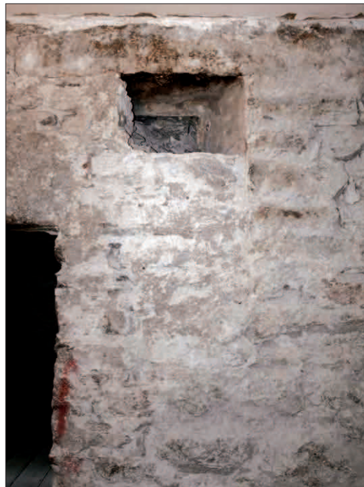
7. Dettaglio di un'apertura originale tamponata dai lavori seicenteschi. (M. Cortelazzo)
