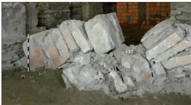
3. Veduta del crollo di uno degli archi pertinenti la chiesa tardomedievale. (S.E. Zanelli)
