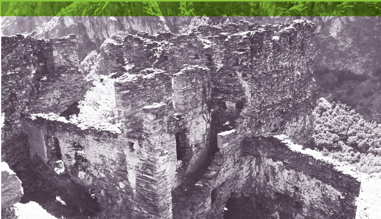
Castello di Saint-Germain di Montjovet (Valle'Aosta, Italia). La messa in sicurezza è un elemento da non sottovalutare nel recupero di siti in rovina. Foto G. Sartorio - RAVA
