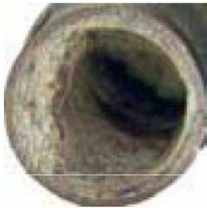
calce nei cavi
