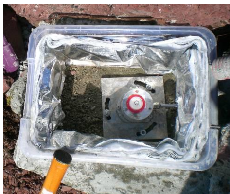
Figure 17 Photo d'un clinomètre installé sur le site de Rubi.
