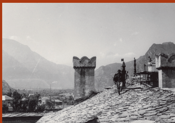
I camini del castello durante i lavori di restauro (AAICRAVA, Catalogo beni storico-artistici e architettonici , Archivio fotografico, Issogne, castello)
