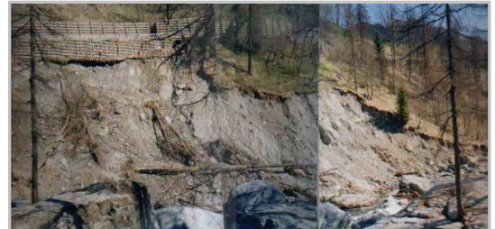
Champorcher: frana in località Parié sulla sponda sinistra del torrente Ayasse
