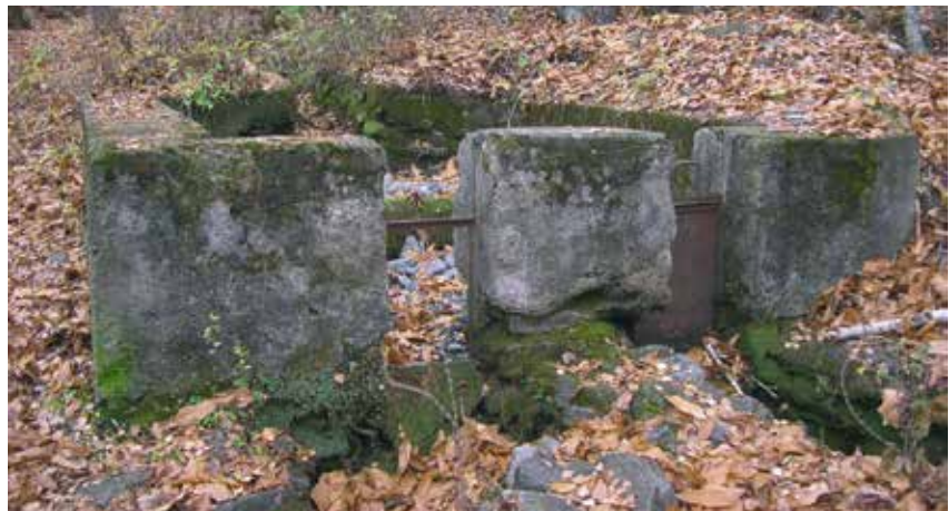
Ammaloramento strutturale di una vasca irrigua - Pontey, Ru Pian - Semon.
